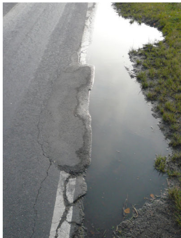
En tre-i-en'er: nedslidt belægning, manglende/ødelagt kant/-afstribing og vandfyldt rabat.
