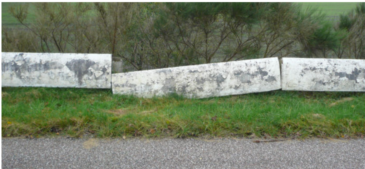
Utidssvarende betonautoværn, som endda er gået i stykker. Disse typer autoværn yder ingen effektiv beskyttelse når et alvorligt uheld først er ude. Tværtimod. Men de ses alligevel stadig mange steder. Foto: Ole Olsen, november 2011
