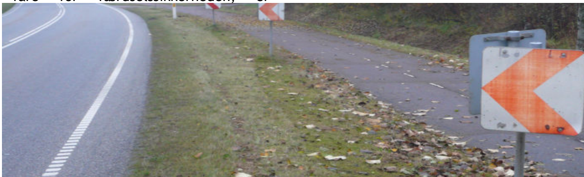
Disse skilte skulle vejlede bilisterne i kurven, men refleksionen på de slidte skilte er nedsat eller væk, og i mørke er de derfor ikke til megen hjælp. Et andet sted var denne type skilt faldet af. Foto: Ole Olsen, november 2011
