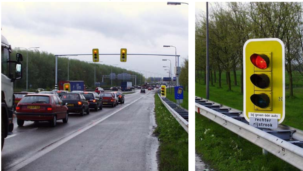
Figur 4.1 Eksempel på 2-sporet rampedoseringsanlæg i Holland. Tavlen til højre viser 'En bil pr. grøn', dvs. her to biler ad gangen, én fra hvert af de to spor.
